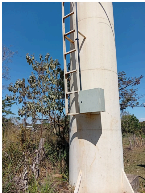
Figura 4: Reservatório São Domingos — painel de telemetria instalado na base da torre.
