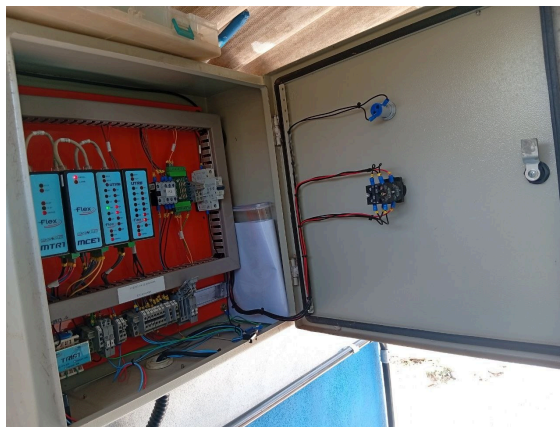
Figura 9: ETE Japaraíba — painel de telemetria com os módulos ControlFlex, instalado na elevatória.
