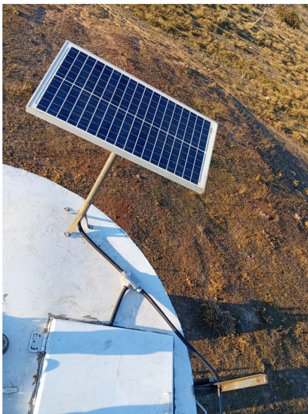
Figura 3: Reservatório Ponte Velha — estação de telemetria alimentada por placa solar, sem rede elétrica no local.
