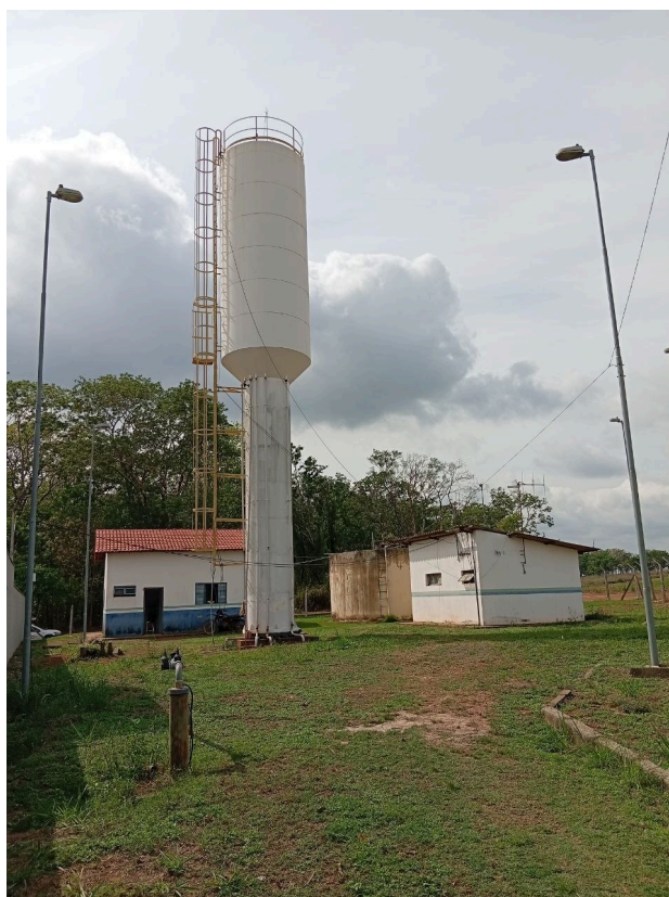
Figura 1: Centro de Reservação de Capoeirão — reservatório elevado, casa de bombas e a antena da estação de telemetria.
