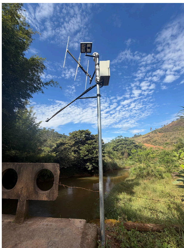
Figura 1: Estação de monitoramento na Ponte Cachoeira do Brumado, com placa solar e antena de rádio.
