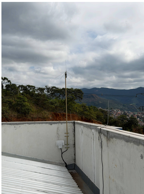
Figura 3: Antena de recepção da central, instalada na sede da Defesa Civil de Mariana.
