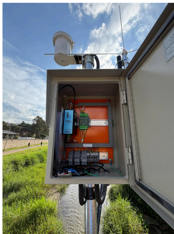
Figura 7: Painel de telemetria com os equipamentos ControlFlex.
