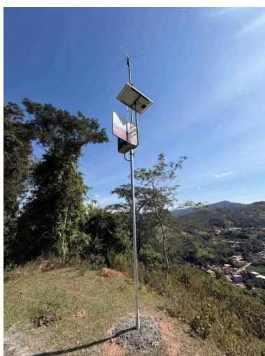
Figura 8: Repetidora de rádio na Cachoeira do Brumado, com placa solar.
