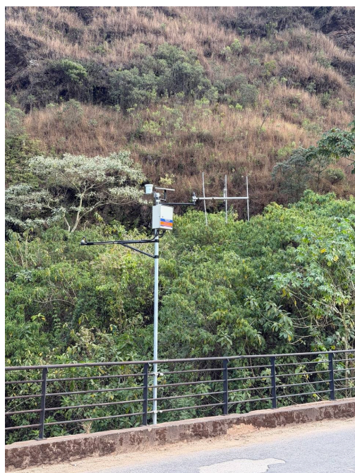
Figura 4: Estação de monitoramento instalada em ponte, na zona rural do município.
